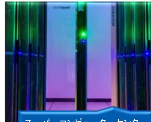
スーパーコンピューターセンター Supercomputer Center
